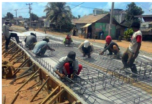
Gambar 9 Pekerja Tidak Memakai APD Lengkap
