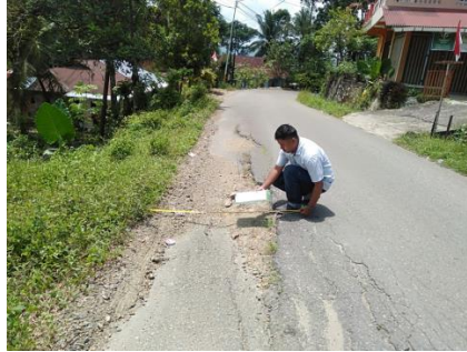
Gambar 4.3 Dokumentasi Lubang ( Potholes )
